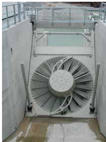
VLH-Turbine im trockenen Betontrog
