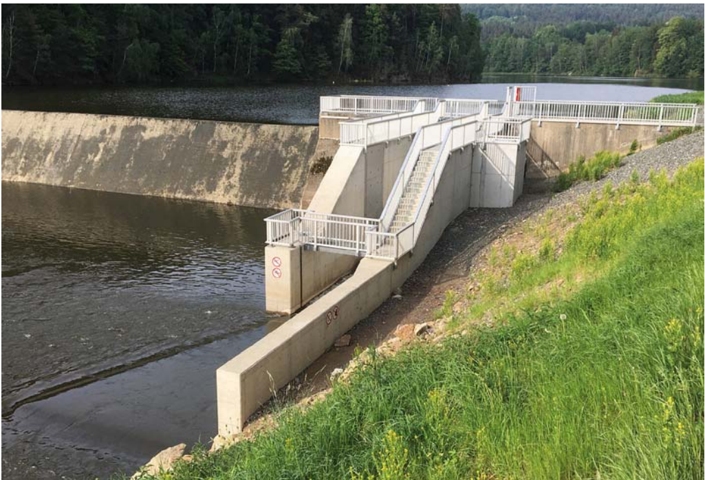
Abb. 3: Die Talsperre Eixendorf im Bayerischen Wald wurde 2017 mit einem beweglichen Kraftwerk an der Vordersperre ausgestattet. Mit einer Fischschleuse direkt neben dem Kraftwerk soll möglichst bald auch noch eine Auf- und Abstiegsmöglichkeit für Fische hergestellt werden. Abb.: Bayerische Landeskraftwerke GmbH
