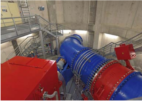
Abb. 2: Das im Sylvensteinspeicher gestaute Hochwasser der Isar erzeugt im Kraftwerk II bis zu 3,8 MW elektrische Energie. Abb. 1 und 2: Hajo Dietz
