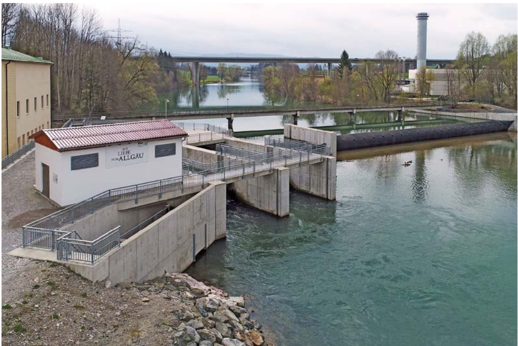
Abb. 1: Gemeinsam mit den Allgäuer Überlandwerken betreibt die Bayerische Landeskraftwerke GmbH dieses Kraftwerk südlich von Kempten an der Iller. Die beiden VLH-Turbinen leisten zusammen 900 kW.
