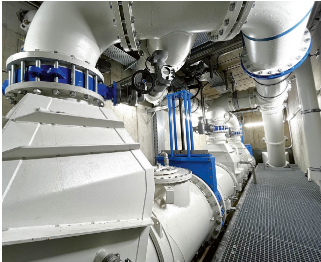
Bild 8: Technicschacht der Druckkammerfischschleuse an der Vorsperre Eixendorf
